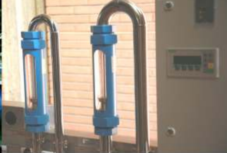
Système de contrôle du débit
