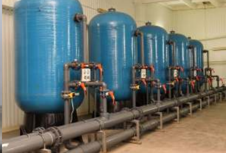
Réservoirs de stockage intermédiaires
