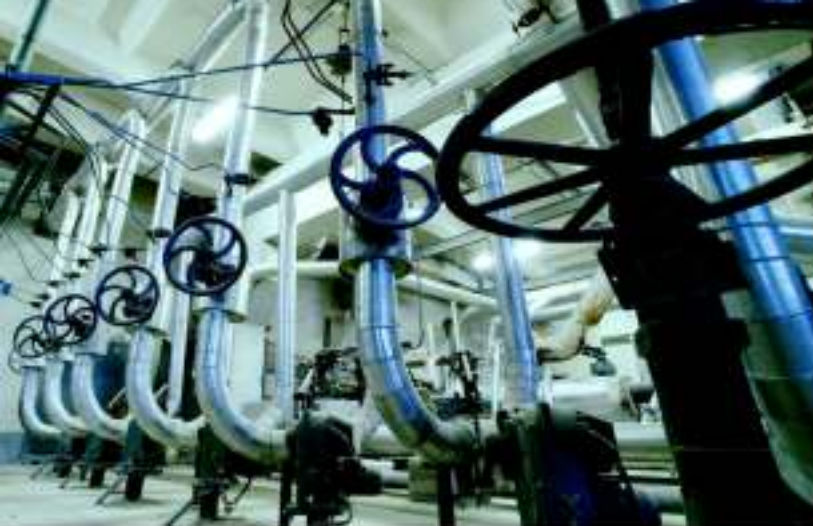
Unité de pompage de l'eau
