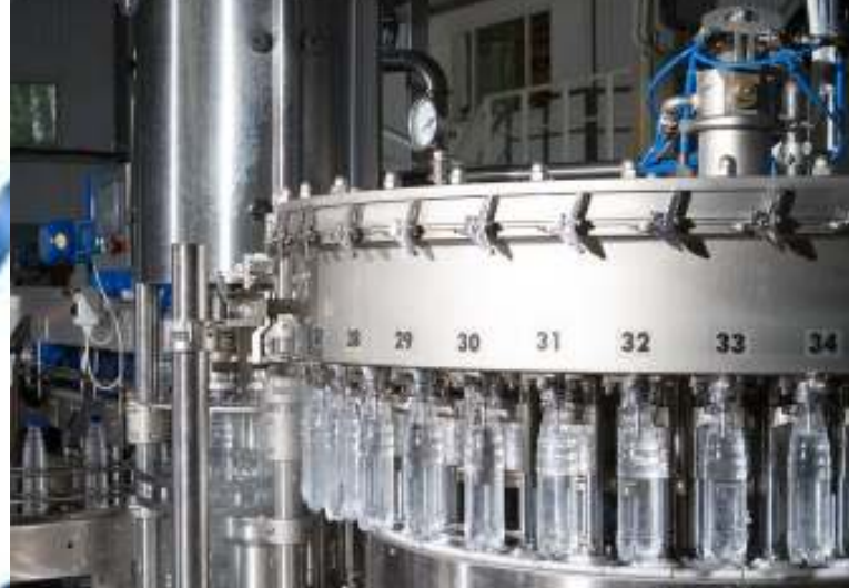
Ligne de remplissage PET
