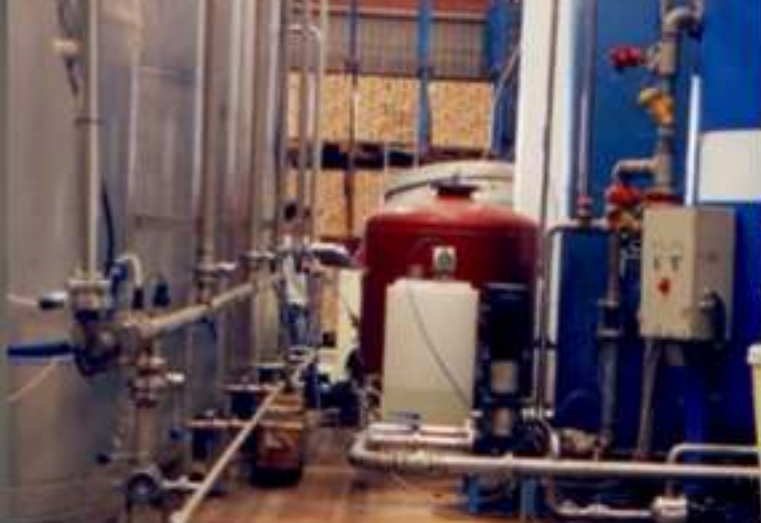
Unité de filtration et de déminéralisation
